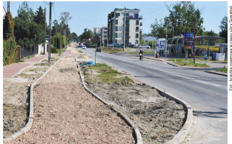
Fot.: ścieżka rowerowa w ciągu ulicy Suwalnej
